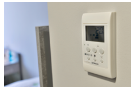
An ein zentrales Gebäudemanagementsystem angeschlossene Hotelfernbedienung
