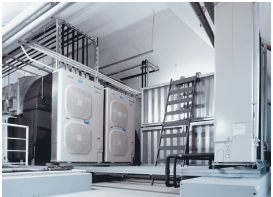
Außeneinheiten mit vertikalem Luftausblas
