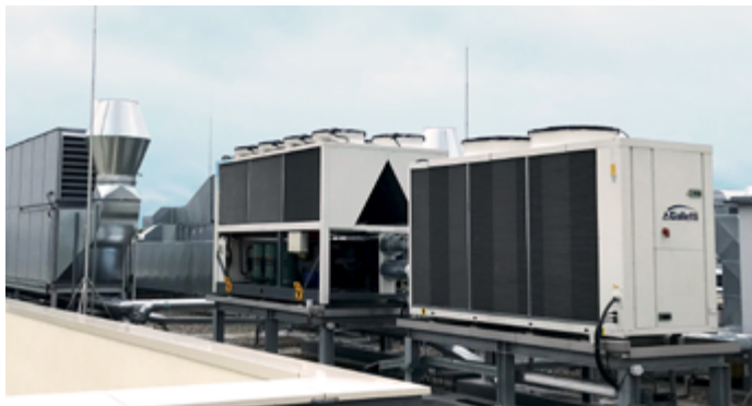
Ein SCX und drei LSE Chiller liefern insgesamt 1,5 MW Kälteleistung
