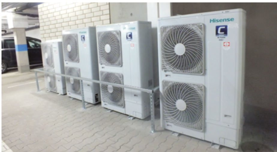
Kompakte MINI VRF-Außeneinheiten von Hisense platzsparend in der Tiefgarage aufgestellt
