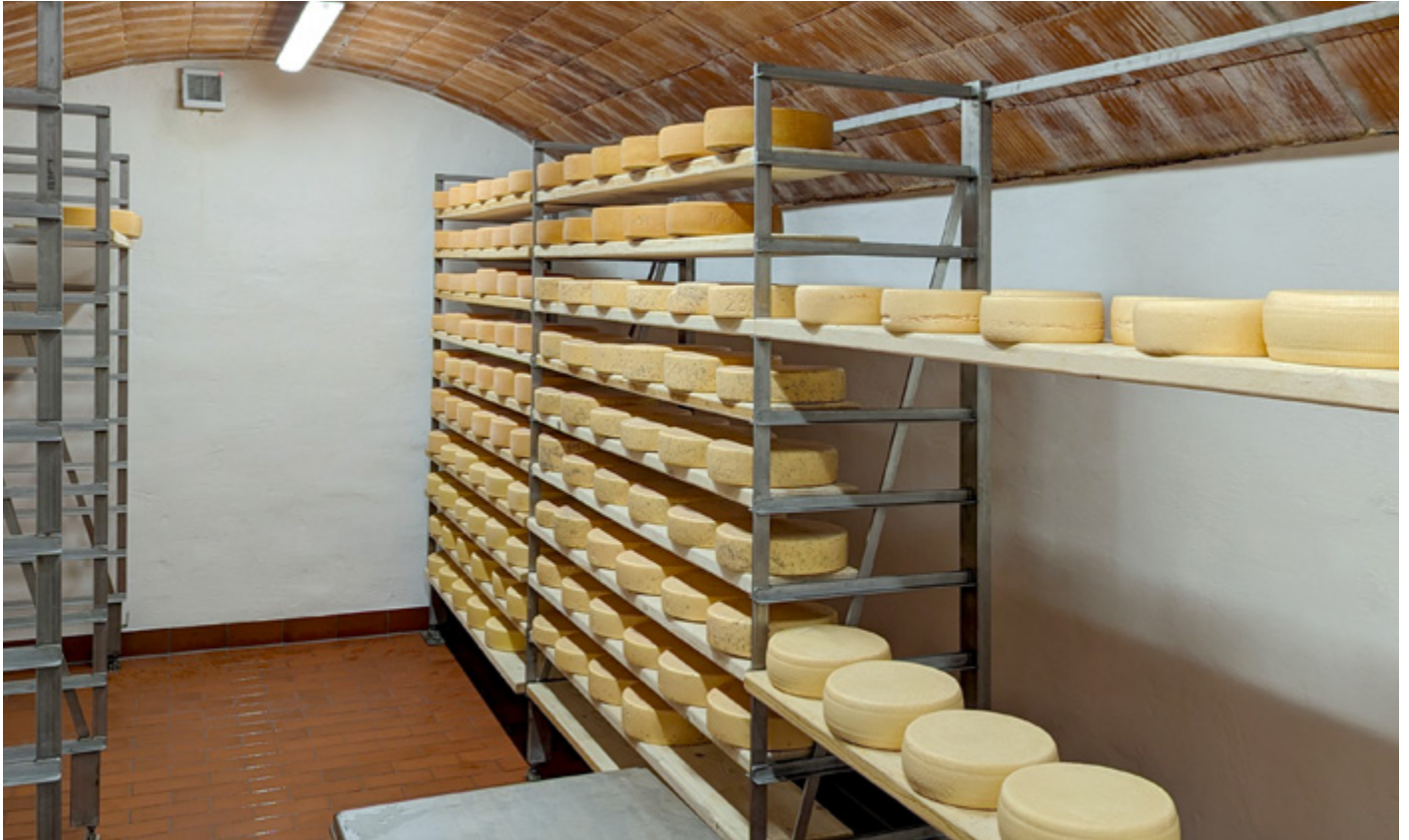
Die Reiferäume der Käserei werden ganzjährig mit im Wandbereich installierten Flächenheizsystemen zuverlässig temperiert.
