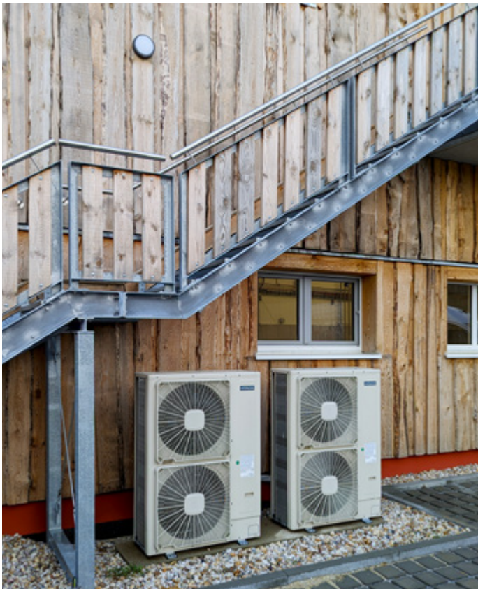
Yutaki S Außeneinheiten vor dem Gebäude
